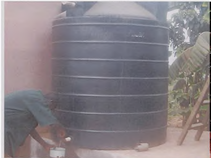
Fig. 23. Tap outlet system
